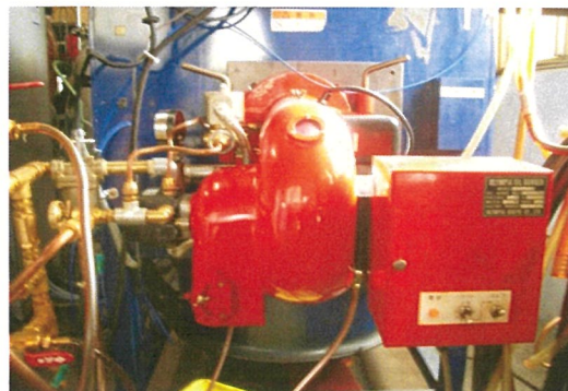
燃焼バーナーとボイラー
